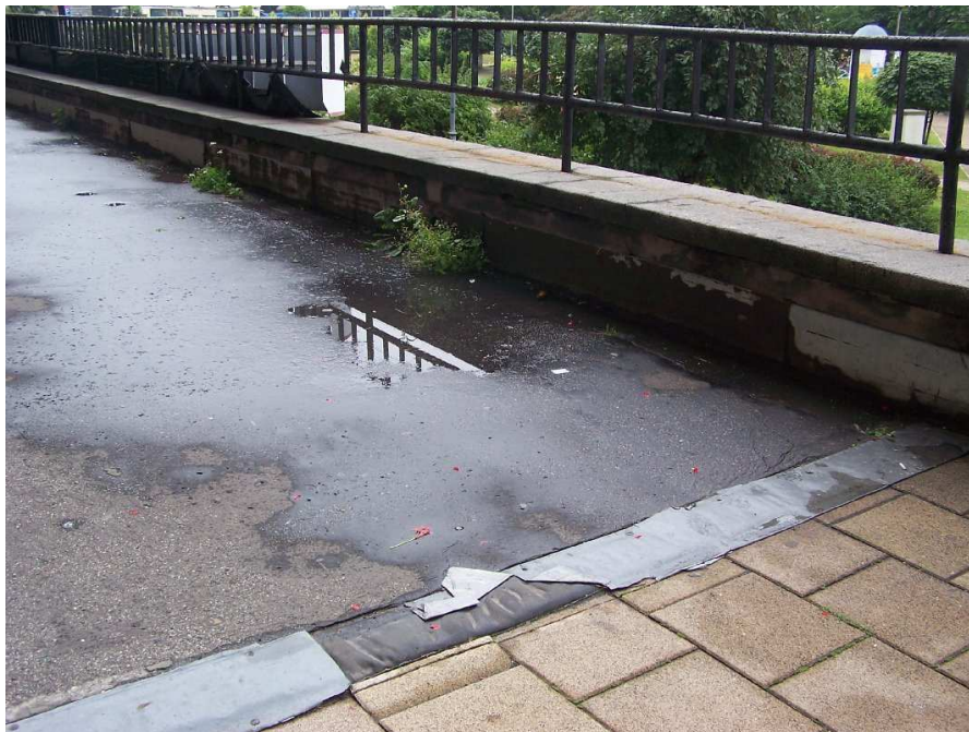
Fot. 7. Zniszczone zabezpieczenie dylatacji.
