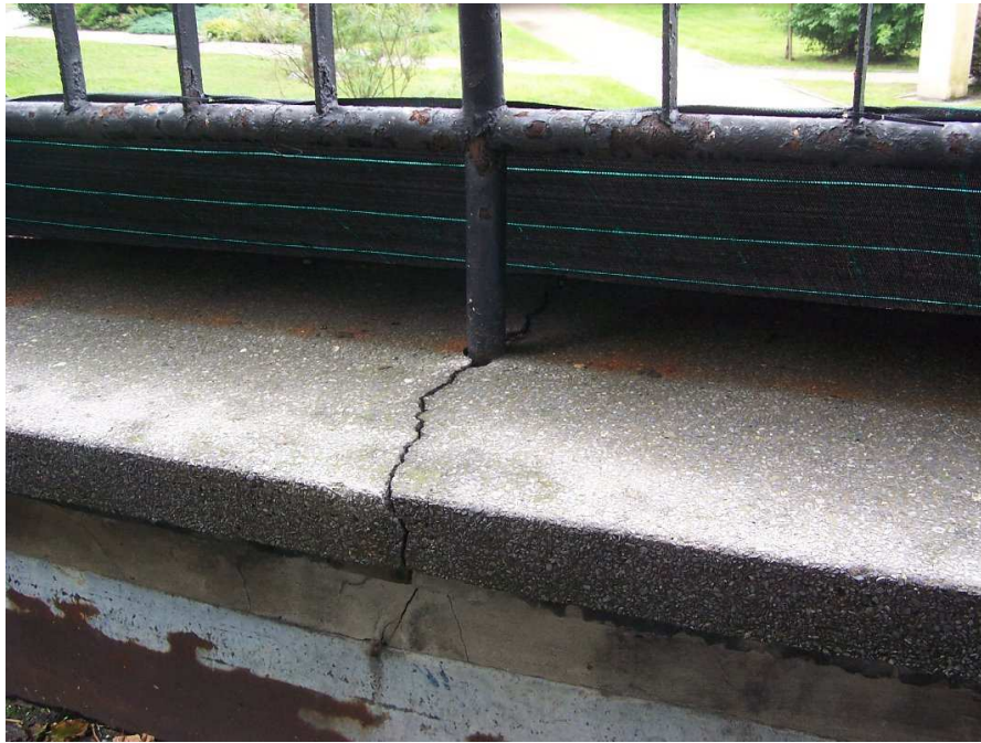
Fot. 8. Pęknięta płyta murku, skorodowane słupki balustrady.
