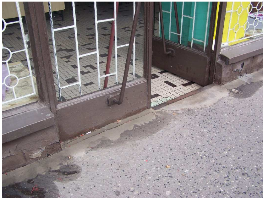
Fot. 9. Brak progów w stolarkę drzwiowej.
