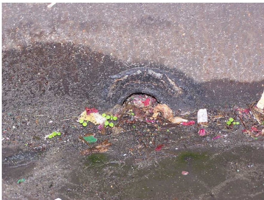
Fot. 1. Zanieczyszczony przepust służący do odwodnienia tarasu.
