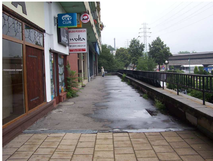
Fot. 3. Różne rodzaje nawierzchni tarasu. Widoczne zastoiny wodne.
