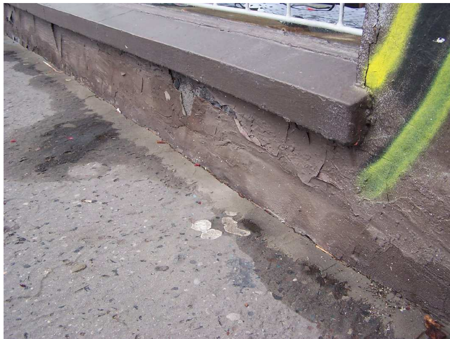
Fot. 5. Ściana zewnętrzna budynku – brak izolacji oraz obróbki blacharskiej.
