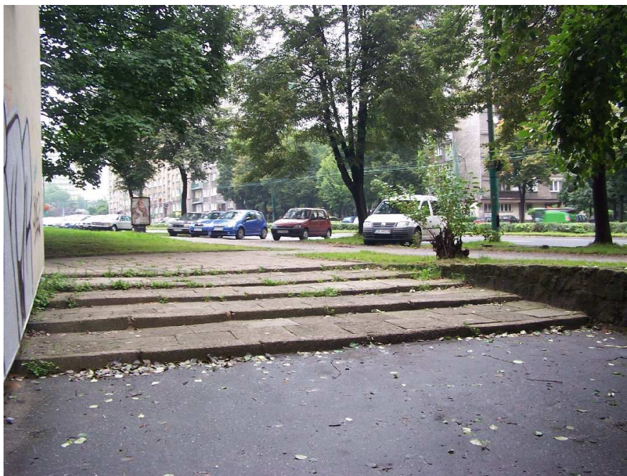
Fot. 15. Zniszczona nawierzchnia schodów i ciągu pieszego.
