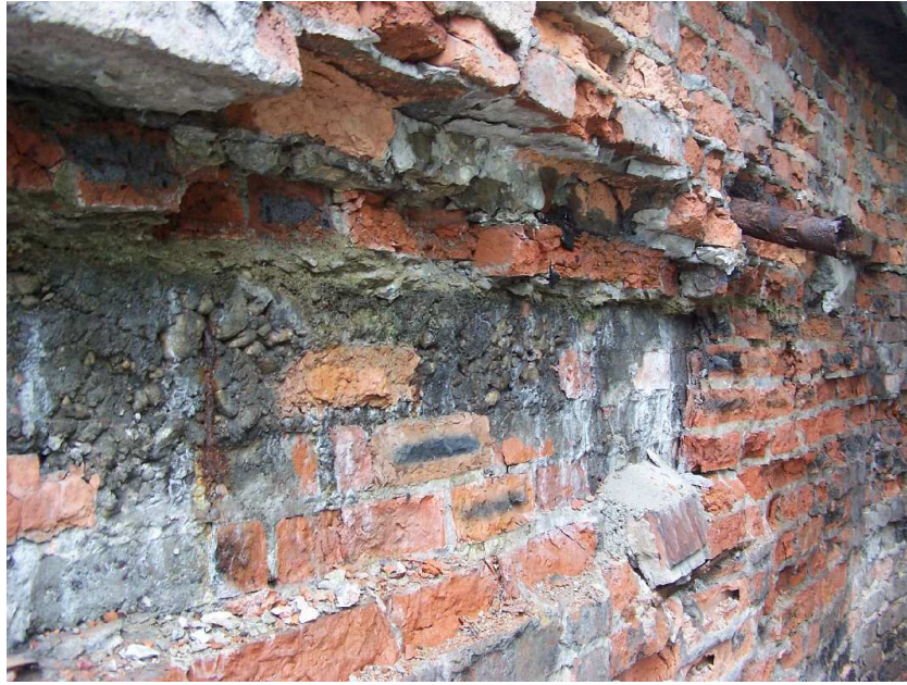
Fot. 10. Zewnętrzna ściana piwnicy. Widoczne liczne ubytki cegieł oraz odkryte i skorodowane zbrojenie wieńca stropowego.
