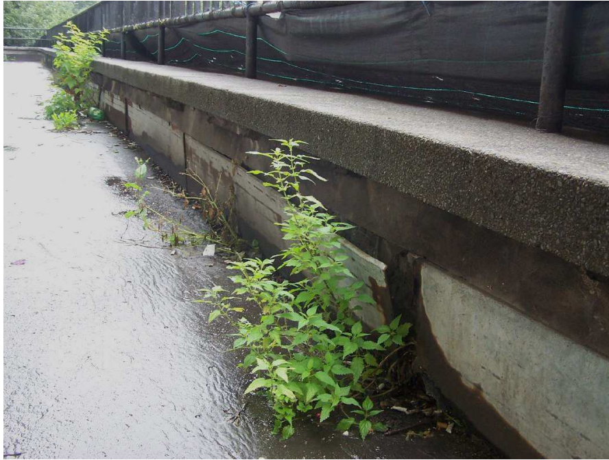
Fot. 6. Zniszczone i skorodowane obróbki blacharskie, porostanie krawędzi roślinnością.
