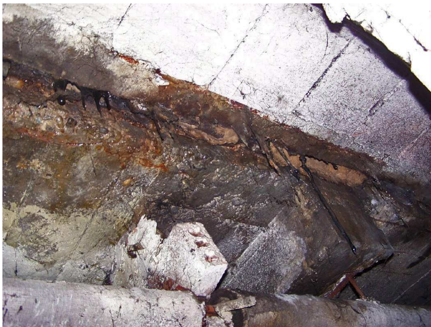
Fot. 12. Dylatacja na styku stropów – widoczne przecieki i zaplamienia.
