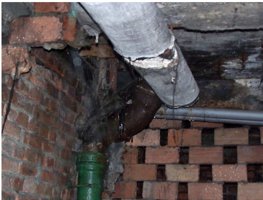
Fot. 14. Rura spustowa – brak uszczelnienia pionu.
