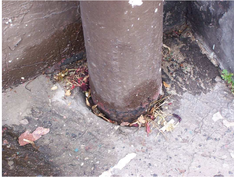
Fot. 2. Brak prawidłowego uszczelnienia przejścia rury spustowej.
